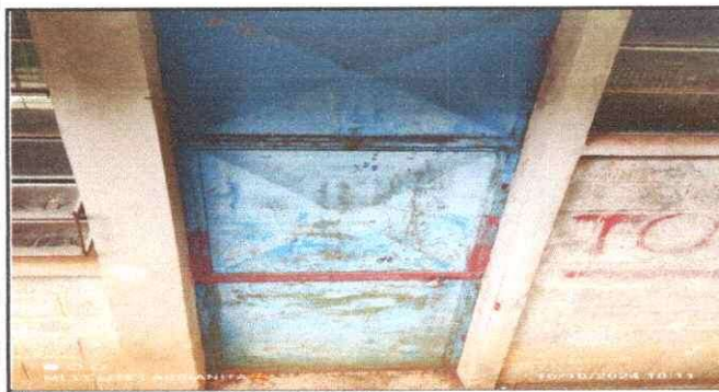
Foto 5: para mantenimiento de puerta
